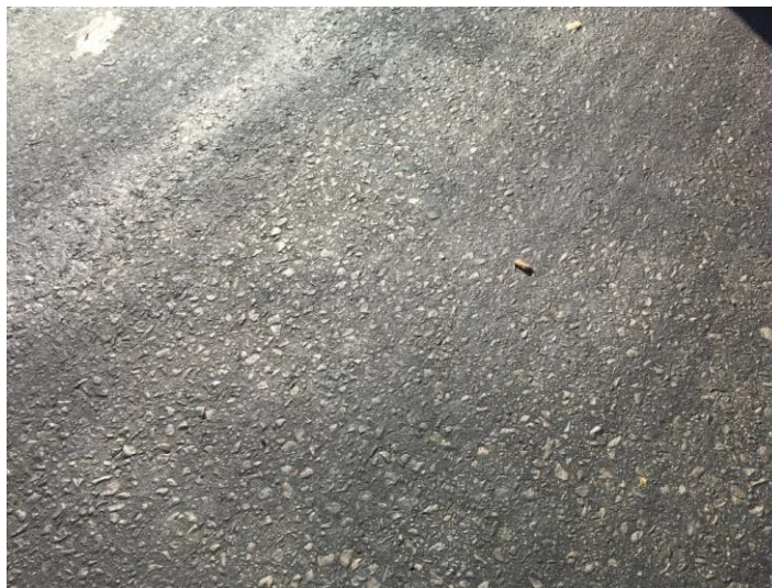
Слика 4.1.5. Мала хрпавост асфалтног слоја – веома углачана површина
