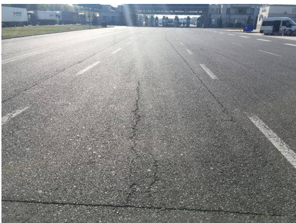
Слика 4.1.15. Подужне пукотине и слабо одрађени подужни спојеви
