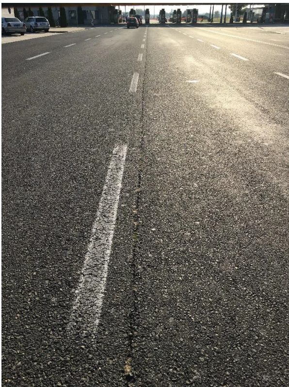
Слика 4.1.24. Подужна пукотина – лоше изведен „шлус“
