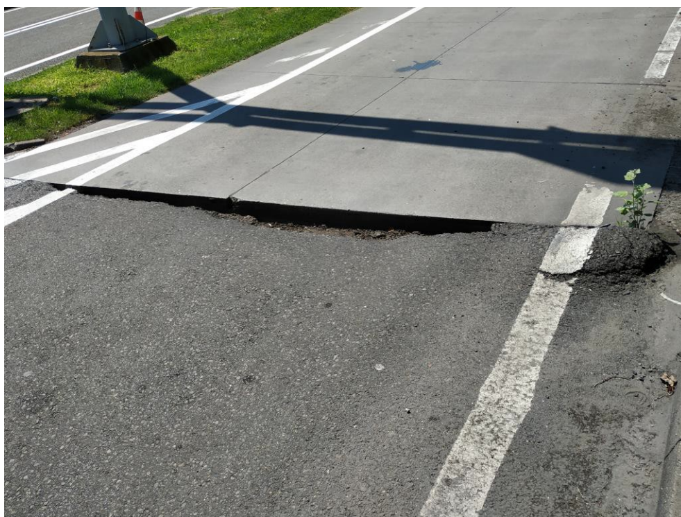
Слика 4.1.19. Оштећење на контакту флексибилне и круте коловозне конструкције
