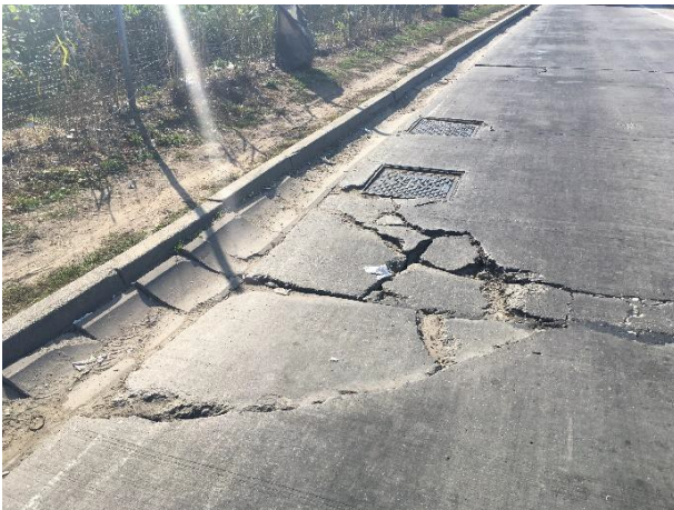
Слика 4.1.11. Лом бетонске плоче у углу
