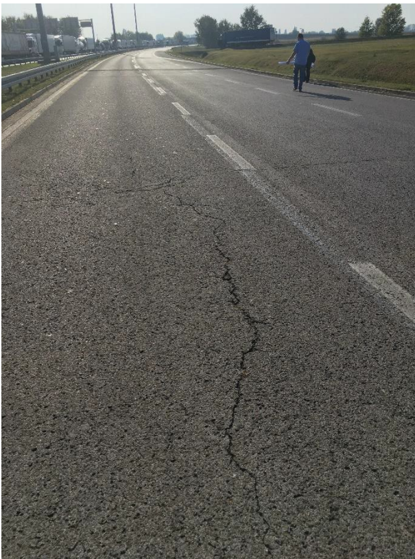
Слика 4.1.30. Подужна и попречна пукотина
