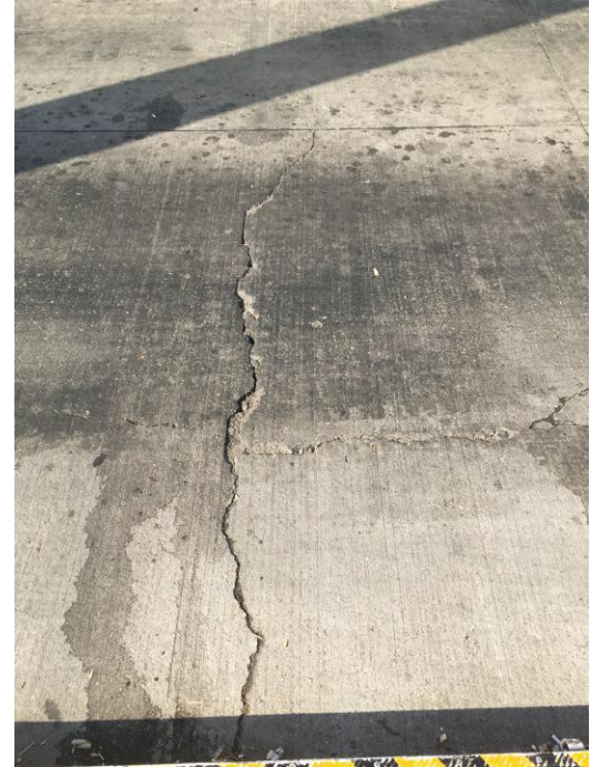
Слика 4.1.10. Пукотина по средини бетонске плоче
