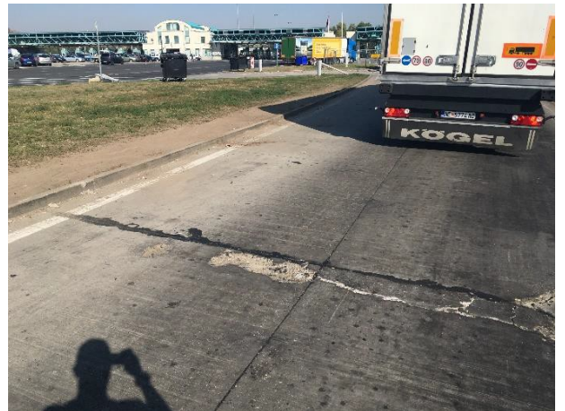
Слика 4.1.12. Лом бетонске плоче у зони просторне спојнице
