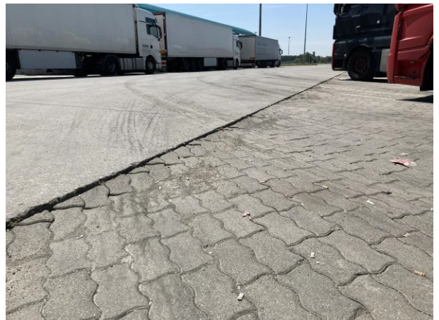
Слика 4.1.23. Локално улегнуће на паркинг површини за камионе
