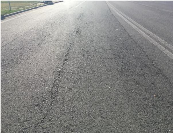
Слика 4.1.17 Пукотине на траци за аутобусе
