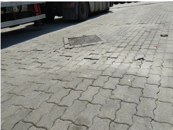
Слика 4.1.22. Локално улегнуће на паркинг површини за камионе
